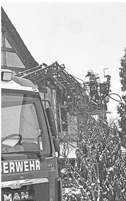
Dachstuhlbrand Volkertshausen Foto: Regina Glatt
